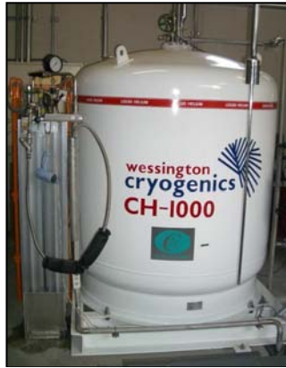
液体ヘリウム 1000L 貯槽
