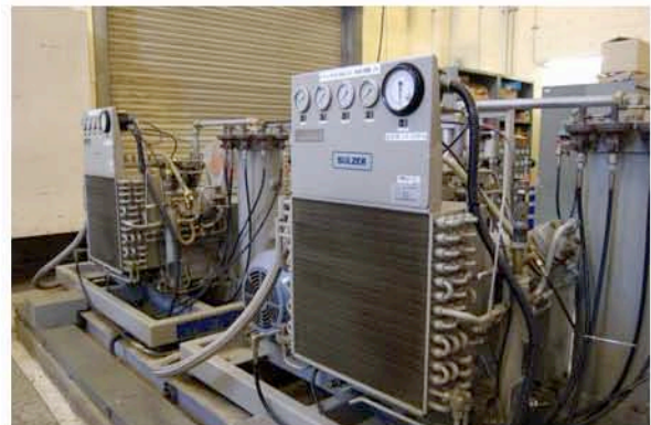
回収用圧縮機
