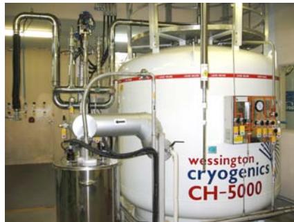
He ポンプ三重管と5000ℓ貯槽
