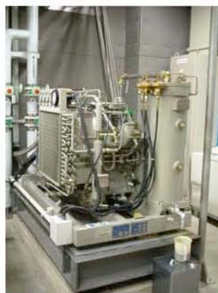
ヘリウム回収用圧縮機
