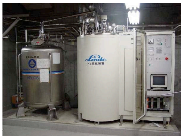
ヘリウム液化機 Linde LHe 貯槽容器
