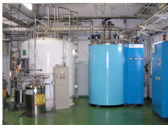
ヘリウム液化機および液体ヘリウム貯槽
