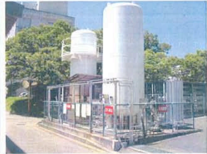
中圧タンク/液化窒素貯槽/蒸発器 15m 3 CE13 60Nm 3 /回収用マニホールド
