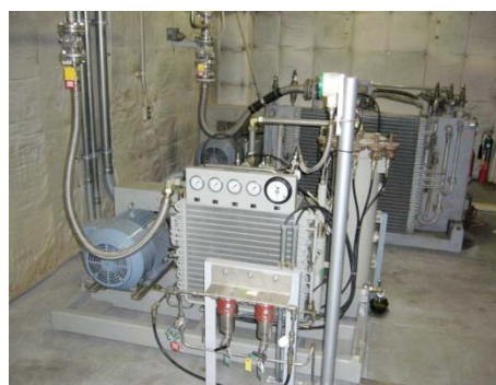
ヘリウム回収用圧縮機（手前・奥）
