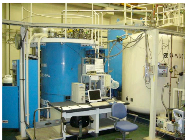
ヘリウム液化機 液体ヘリウム貯槽
