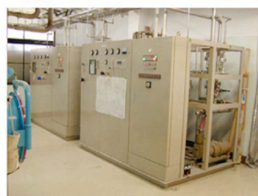
ヘリウムガス乾燥器、奥高圧、手前中圧
