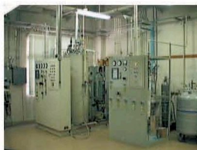
外部精製器と中圧ガスドライヤー
