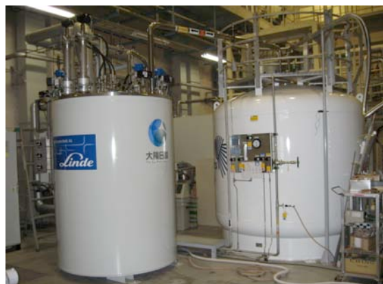
ヘリウム液化機 LHe貯槽
