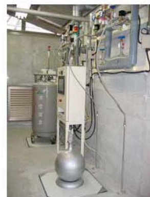
液体窒素自動充填システム
