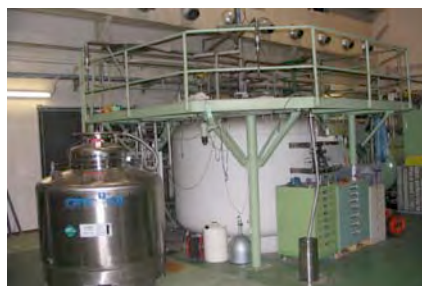
液化ヘリウム貯槽
