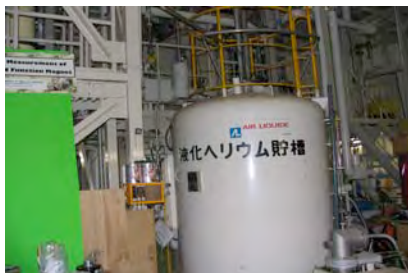
液化ヘリウム貯槽
