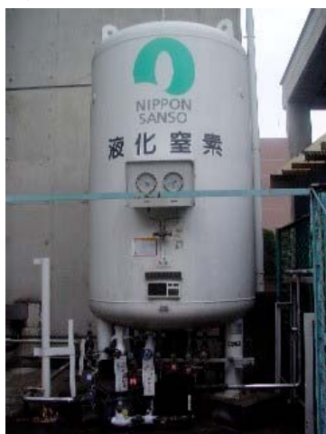
液体窒素貯蔵タンク
