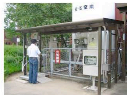
液体窒素貯槽と自動供給装置
