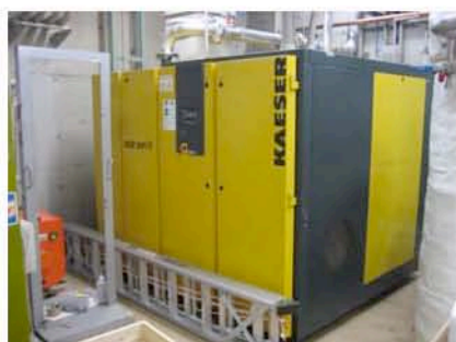
液化機用ヘリウム圧縮機 (KAESER DSD201)
