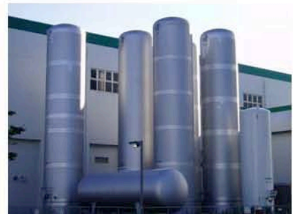
タンクヤード
