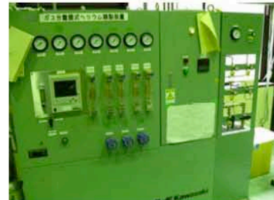
ガス分離膜式ヘリウム精製装置
