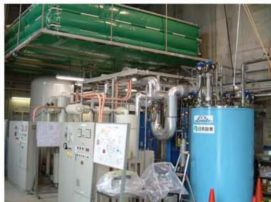
乾燥機、バッファタンク、液化機、(上)ガスバッグ
