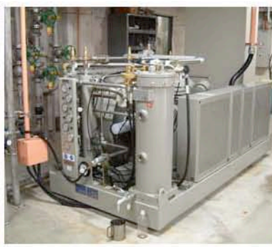
回収圧縮機(GreenField)
