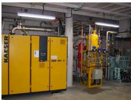
液化用圧縮機、油分離機、回収圧縮機 (東亜潜水)
