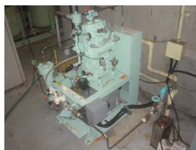
回収圧縮機 東亜潜水機 YS75
