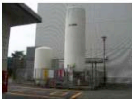
液体窒素貯槽
