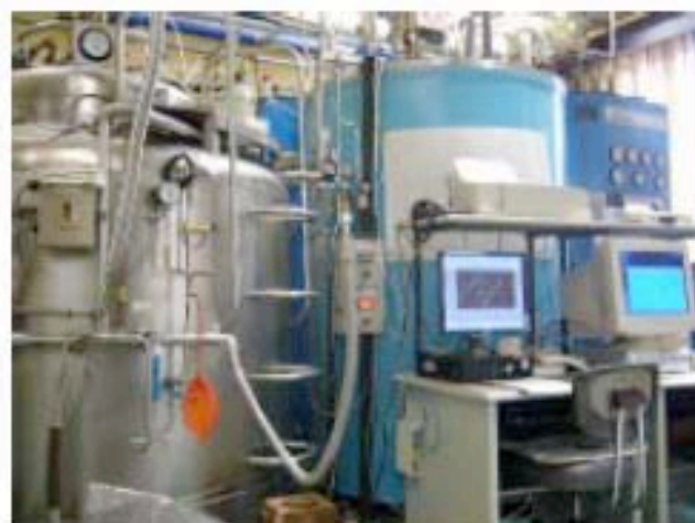
液体ヘリウム貯槽・ヘリウム液化機
