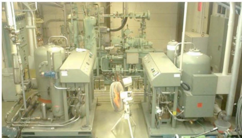
液化用圧縮機 左：PSI RSJ 既設 右：PSI RSJ 北陸先端大から移設
